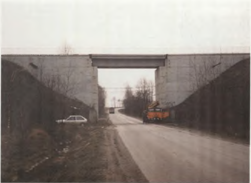
Fot.1.20. Na ścianach skrzydła widoczne są kolejne etapy rektyfikacji niwelety toru (nadbudowy przyczółków) Photo.1.20. Visible on the wing walls are the successive stages of rectification of track formation line (superstructure of abutment and longitudinally)
