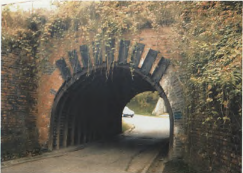
Fot.1.22. Doraźne wzmocnienie porysowanego podłużnie i poprzecznie łukowego wiaduktu ceglanego oraz przystosowanie go do przejęcia wpływów eksploatacji górniczej Photo.1.22. Emergency reinforcement of longitudinally and transversally scratched brick arched overpass and its adaptation to reception of the influences of mining
