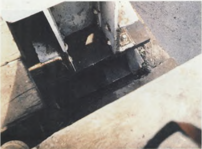
Fot.1.6. Przesunięte łożysko stałe w kierunku środka przęsła Photo.1.6. Shifted permanent bearing in the direction of span centre
