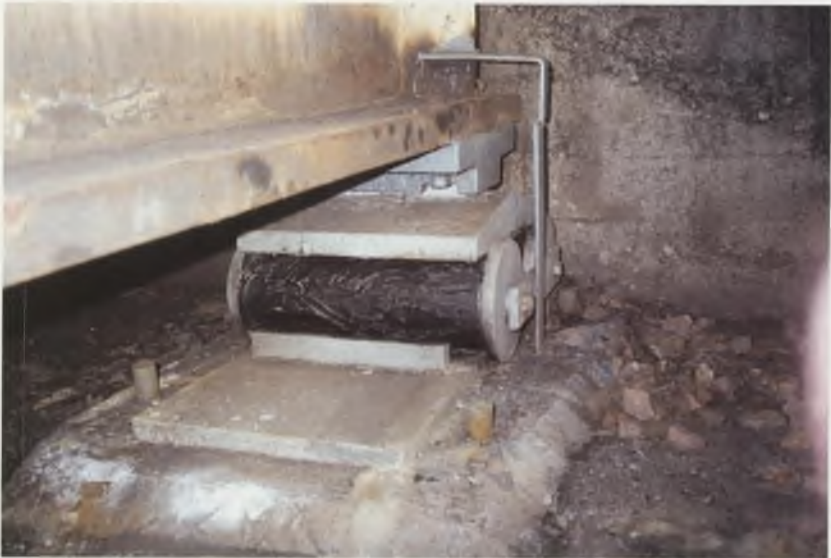
Fot.1.4. Poprzeczne przesunięcie przęsła na łożysku Photo.1.4. Transverse shifting of span on a bearing
