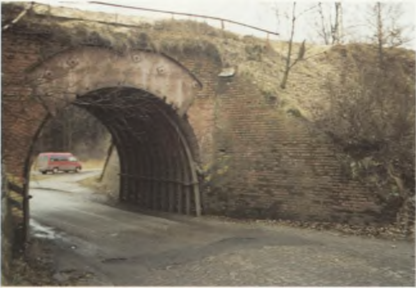
Fot.1.21. Doraźne wzmocnienie porysowanego podłużnie i poprzecznie łukowego wiaduktu ceglanego oraz przystosowanie go do przejęcia wpływów eksploatacji górniczej Photo.1.21. Emergency reinforcement of transversally scratched brick arched overpass and its adaptation to reception of influences of mining
