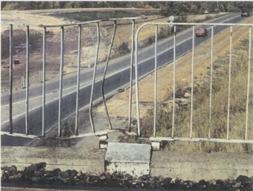
Fot.1.8. Uszkodzenie poręczy z powodu braku dylatacji Photo.1.8. Railing damage resulting from lack of dilation
