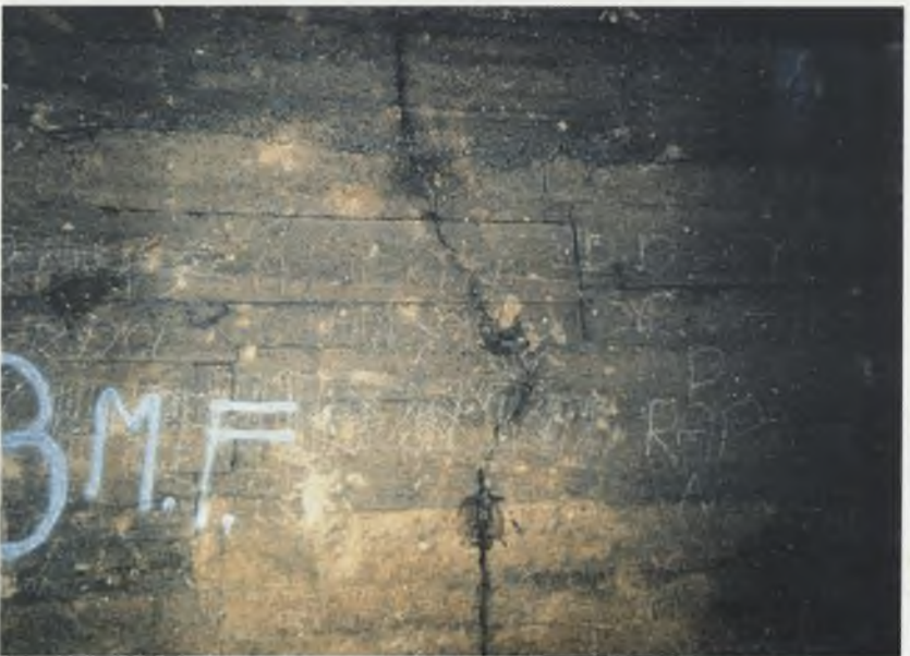
Fot.1.10. Szczelina przebiegająca przez ścianę przyczółka Photo.1.10. A fissure running through abutment wall
