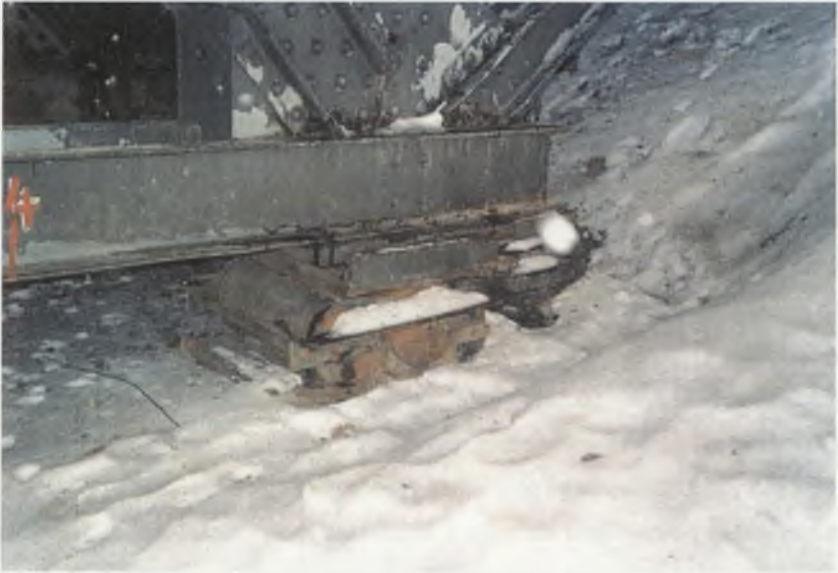
Fot.1.1. Awaryjne przesunięcie przęsła kratowego na łożysku ruchomym i jego doraźne podparcie Photo.1.1. Failure shifting of grid span on expansion bearing and its emergency support
