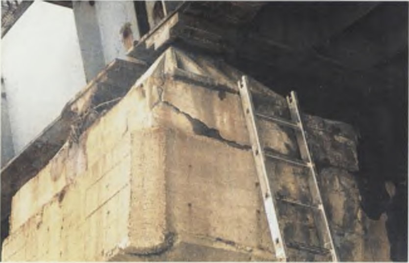
Fot.1.7. Ścięcie ciosu podłożyskowego od przesuwania się łożyska stałego Photo.1.7. Shearing of sub-bearing cut stone from the shifting of permanent bearing
