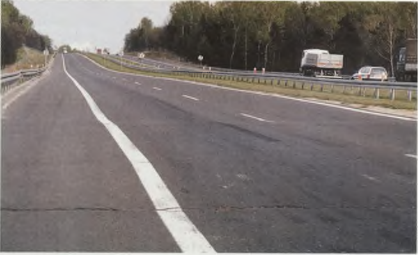
Fot.1.15. Deformacja jezdni autostrady A-4 w obrębie przepustu (Mysłowice) Photo.1.15. Deformation of motorway A-4 road within the culrest (Mysłowice)
