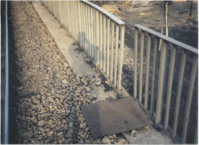
Fot.1.9. Widoczne na poręczy przesunięcie poprzeczne przęsła Photo.1.9. transverse shifting of span visible on the railing
