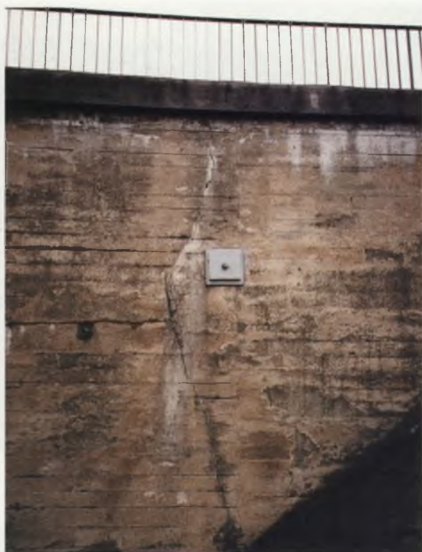
Fot. 1.13. Pionowe i poziome pęknięcie skrzydła przyczółka Photo.1.13. Vertical and horizontal cracking of abutment wings
