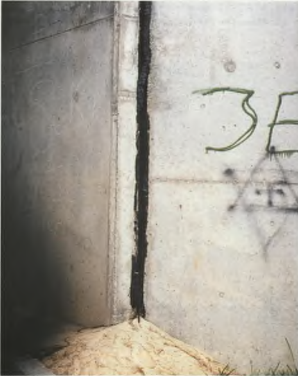
Fot.1.16. Odsunięcie się skrzydeł przepustu od konstrukcji i wypłukanie piasku z korpusu nasypu drogowego Photo.1.16. Retreating of the pass wings from the structure and washing out of sand from the body of road embankment
