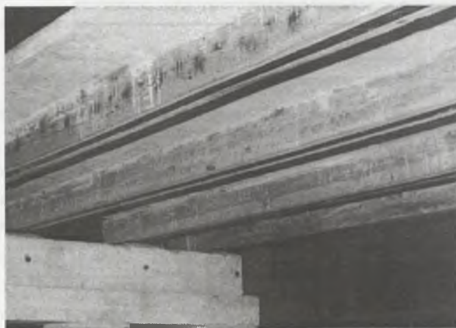
Rys. 2. Widok od spodu wzmocnienia modeli stropu zespolonego drewniano-żelbetowego wykonanego taśmą zbrojoną włóknami węglowymi SikaCarboDur S512
