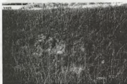
Fot. 3. Skarpa w pobliżu budowli 1 niezabezpieczona przed erozją Fot. 3. Slope near structure 1 without erosion control
