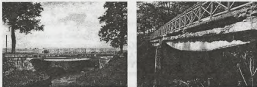
Rys. 1. Przykłady mostów z dźwigarami taśmowymi Fig. 1. Bridge examples with steel band girders
