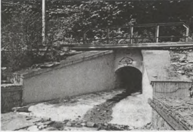
Rys.12. Widok przepustu na linii kolejowej Żywiec – Zwardoń, w pobliżu miejscowości Sól. Remont kapitalny tego przepustu wykonano w sierpniu 1997 r. Zdjęcie wykonano w październiku 2004 r.
