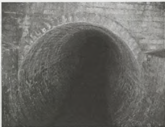
Rys.9. Kolektor deszczowy o średnicy 1600mm, licowany murem z cegły prasowanej betonowej z betonu B 25, wykonany w Rydułtowach w 1997 r. Stan na zdjęciu z października 2004 r. Widok z komory rewizyjnej w stronę odpływu
