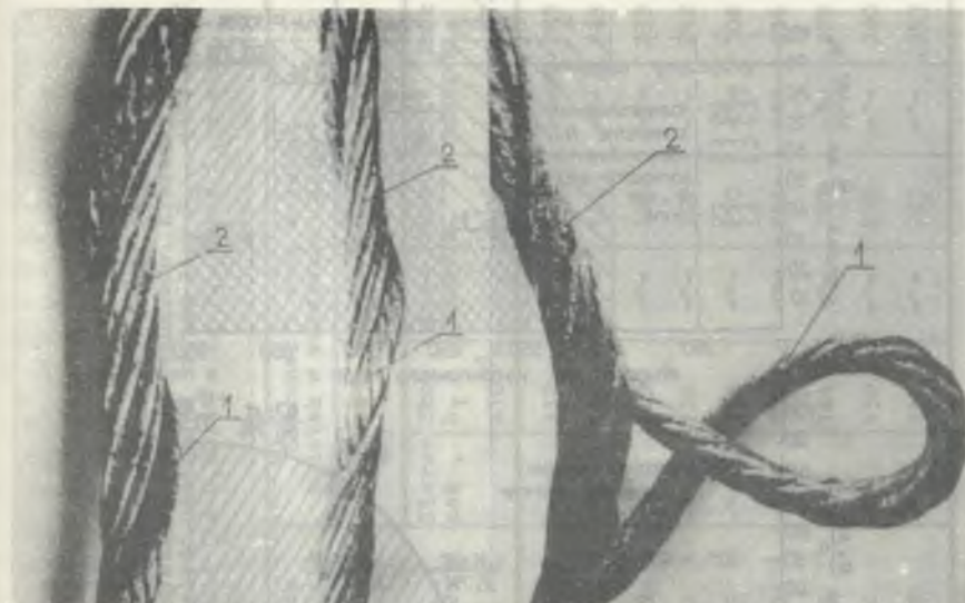
Rys. 2. Widoki kolejnych faz deformacji liny wyrównawczej okrągłej typu GIG w postaci samodzielnego rozwarstwiania się liny w szybie (wychodzenia splotek warstwy wewnętrznej na zewnątrz liny)
