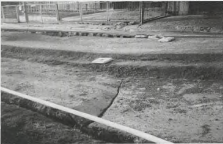
Rys. 2. Zapadnięcie się drogi z widocznymi 4 podłużnymi spękaniem konstrukcji wynikającymi z niewłaściwego rozpoznania podłoża, które uległo procesom sufozji Fig. 2. Cracking of a-road has four longitudinal break construction caused by wrong recognized ground which gave up of internal erosion of soil
