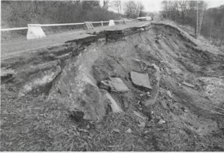
Rys. 3. Przykład osuwiska drogi krajowej spowodowanego procesami sufozji niewłaściwie rozpoznanych gruntów podłoża
