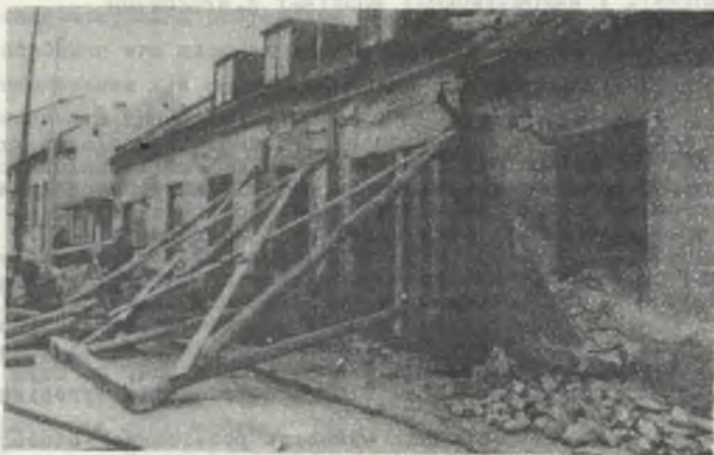
Fot. 1. Dom zniszczony wskutek obwałów jego podziemi
