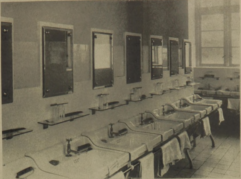
So soll ein Waschräume in einem Staub- oder Giftbetrieb aussehen. Handbürste, Zahnbürste und Kamm dürfen hier nicht fehlen. Aufn. Archiv „Schönheit der Arbeit“
