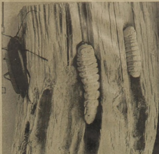
Valkenstück vom Kulm oder Zimmermannsbock befallen. Die Larven und Fraßgänge der Larven sind deutlich erkennbar. Links ein Käfer. Werkfoto: Allgem. Holzimprägnierung GmbH, Berlin
