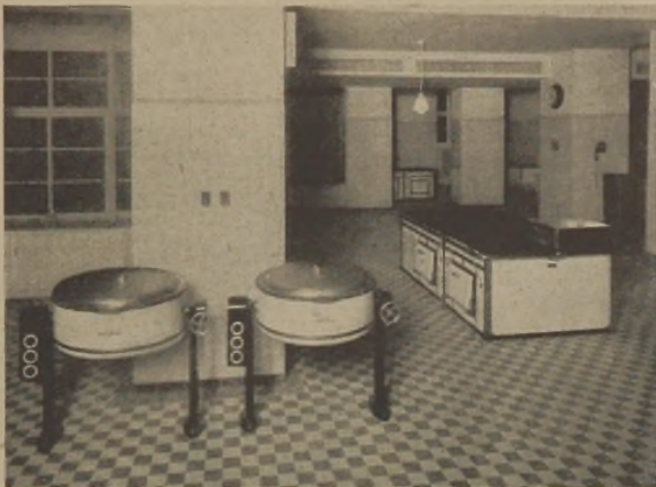
Elektriküche eines Mittelbetriebes. Im Vordergrund: Kippbratpfanne Werkfoto Küppersbusch
