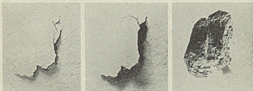
Abb. 45—47. Sprengformwirkung im Putz.
