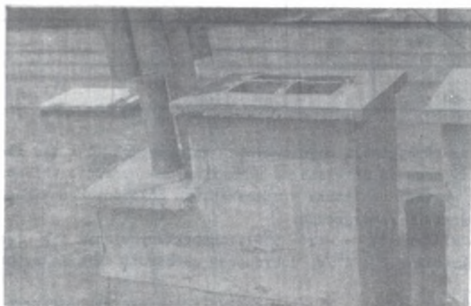
Rys. 7. Wylot z kanału zbiorczego układu wentylującego mieszkania
