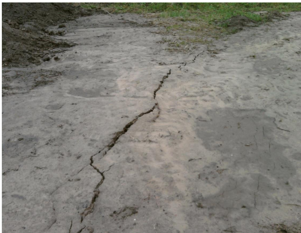
Rys. 7.3. Deformacja nieciągła obok budynku przy ulicy Wiśniowej 71
