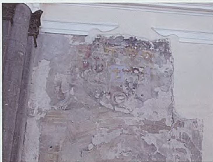
Wymagające renowacji malowidło kontrastujące z odnowionymi już ścianami kościoła
