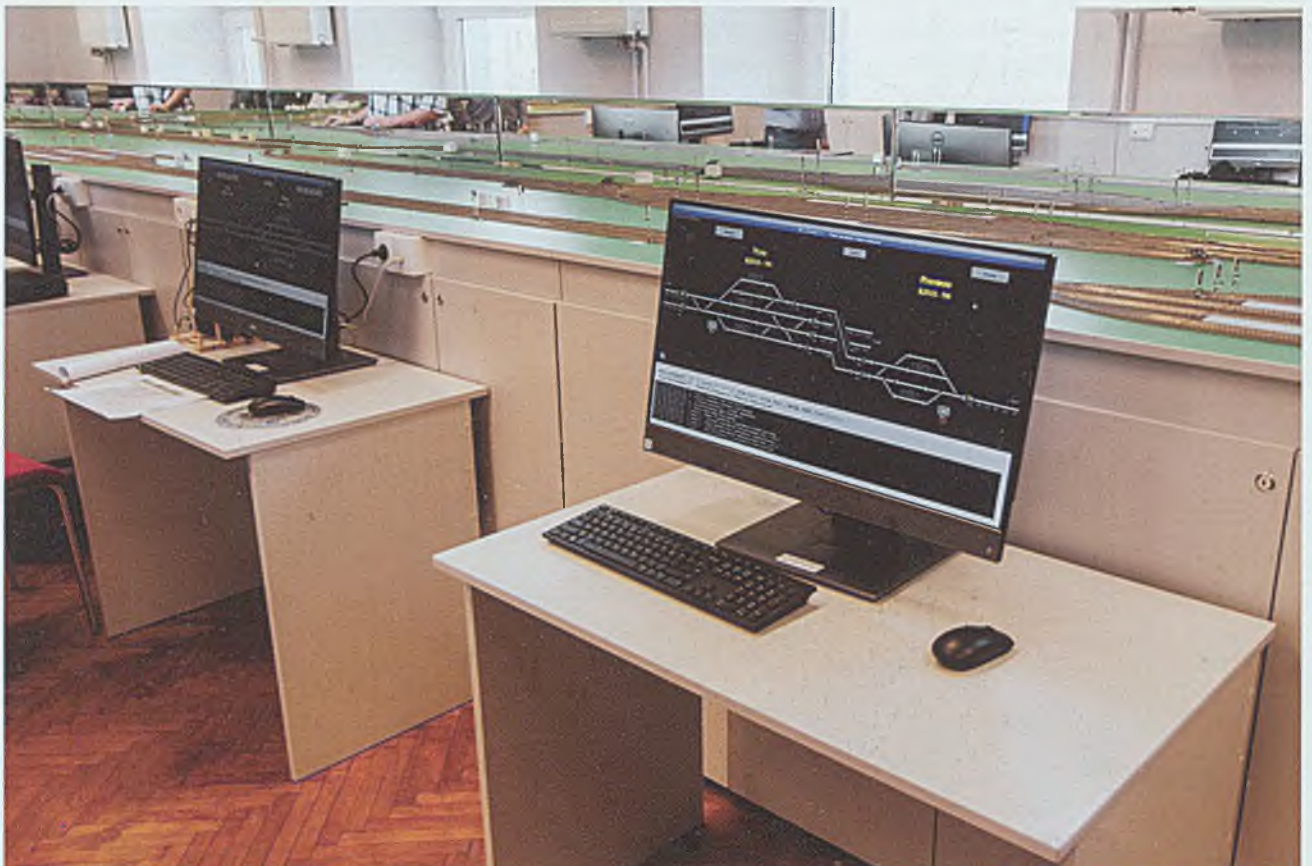
Komputerowe stanowiska sterowania ruchem kolejowym / fot. Maciej Mutwil
