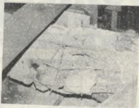
Rys. 8.11c. Zniszczony segment w pierścieniu obudowy po przekroczeniu granicznej wielkości jego obciążenia (badanie nr 1 - tablica 8.3)
