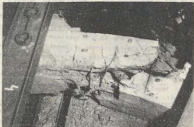
Rys. 8.23. Zniszczony przekrój obudowy w niesymetrycznie obciążonym segmencie siłownikiem P3 (rys. 8.24), przy wielkości akcyjnego obciążenia pierścienia p = 1,6 MPa (badanie nr 5 - tablica 8.3)
