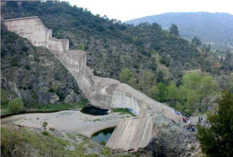
Zniszczona betonowa zapora w Malpasset, Francja (Diederichs, 2003). W 1959r. Katastrofa spowodowała śmierć 450 ludzi.
