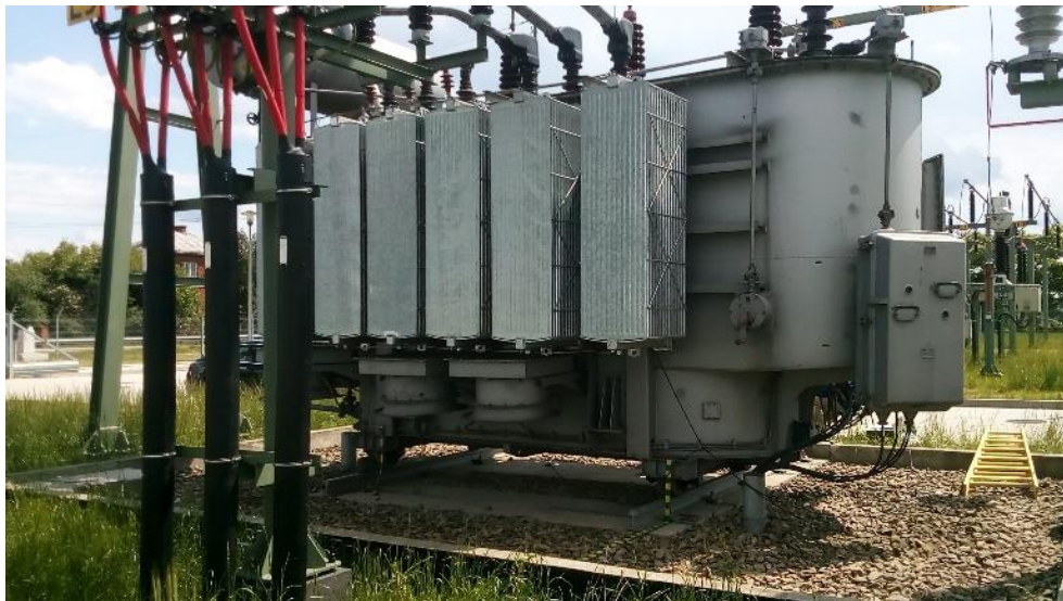
Fig. 2. Diagnosed oil power transformer Rys. 2. Widok diagnozowanego olejowego transformatora energetycznego
