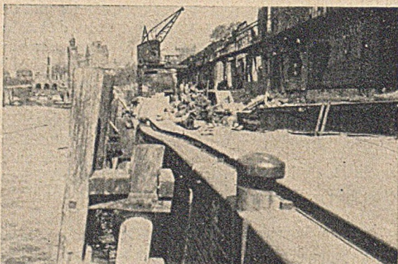
Abb. 3. Zerstörte Kaimauer am Johannishöllwerk. — Setzung der Kaimauer durch Einrüttlung der Pfähle und Bodenauflockerung (Fall 3).
