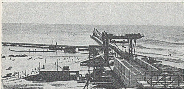
Abb. 3. Blick über die Baustelle mit Kastenfabrik, Portalkran für 200 t Hub, im Hintergrund die Nordmole mit Kran, links die Anlegemole mit Bauhafen.
