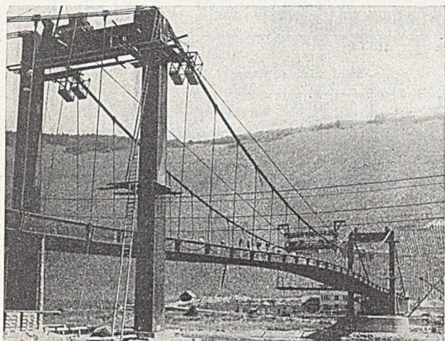
Abb. 25. Die starken Verformungen der Kabel bei noch ungleicher Belastung, solange die Fahrbahn erst teilweise aufgebracht ist.
