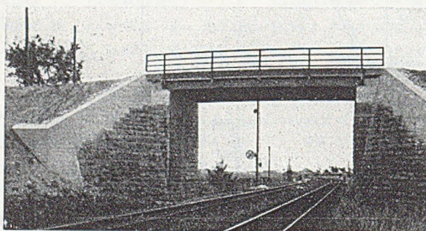
Abb. 3. Schlechtes Beispiel einer Widerlagererhöhung.
