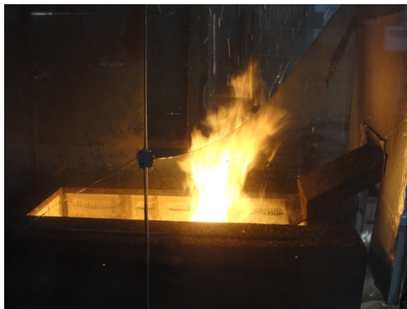
Rys. 4.1 Widok na komorę paleniskową podczas pracy
