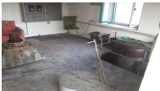
Rys. 5.1.2 Pomieszczenie techniczne elektrowni
