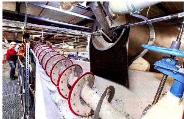
Rys. 2.4 Instalacja odzysku szkła z panelu fotowoltaicznego [12].
