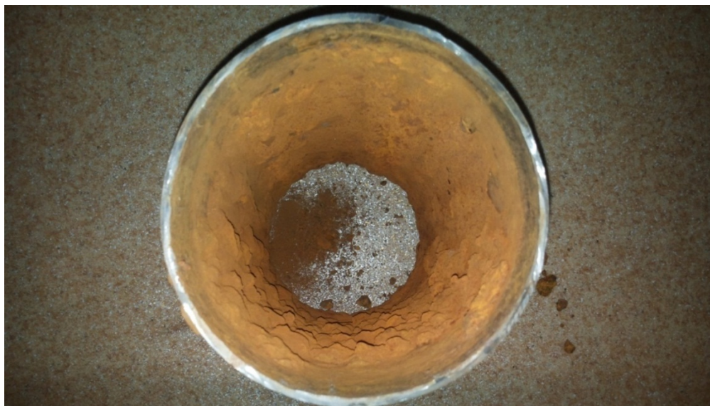
Rys. 3.2 Korozja ogólna na przewodzie wykonanym ze stali ocynkowanej; wyk. Martina Kaczmarzyk
