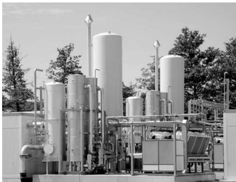
Rys. 2. Biogazownia w Schwandorf w Niemczech (przepływ biogazu 2000Nm 3 /h) [13]
