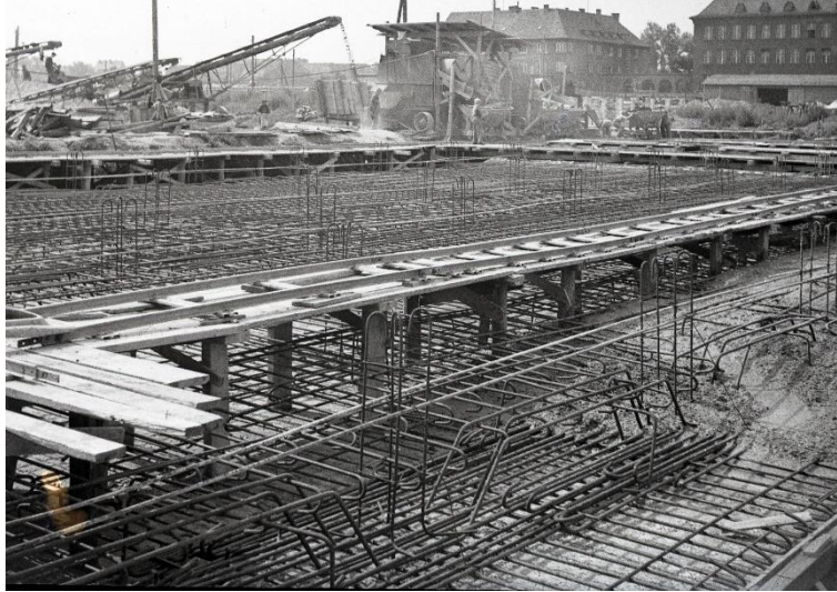
Rys. 5.2. Zbrojenie płyty i ław fundamentowych gmachu Wydziału Inżynieryjno-Budowlanego widoczne podczas budowy w roku 1949/50 (w tle, z prawej strony widoczny fragment gmachu Wydziału Elektrycznego z pobliskim budynkiem) (zbiór: Archiwum Politechniki Śląskiej)
