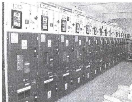
Rys. 12. Wyposażenie rozdzielni Fig. 12. Equipment in the dispatch and switching station
