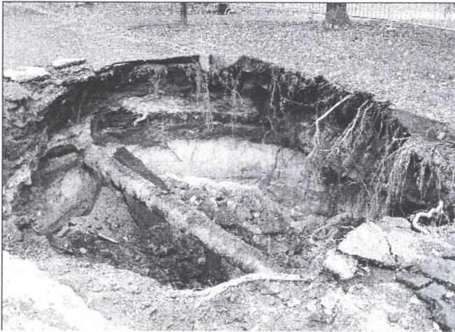
Rys. 1. Deformacja nieciągła terenu górniczego na obszarze dawnej płytkiej eksploatacji Fig. 1. Discontinuous deformation of mining terrain in the area of old shallow exploitation
