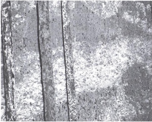
Fot. 1. Przykład sedymentacji mieszanki betonowej w trakcie wykonywania obudowy szybu Photo 1. The example of concrete mixture sedimentation in the time of the shaft lining construction
