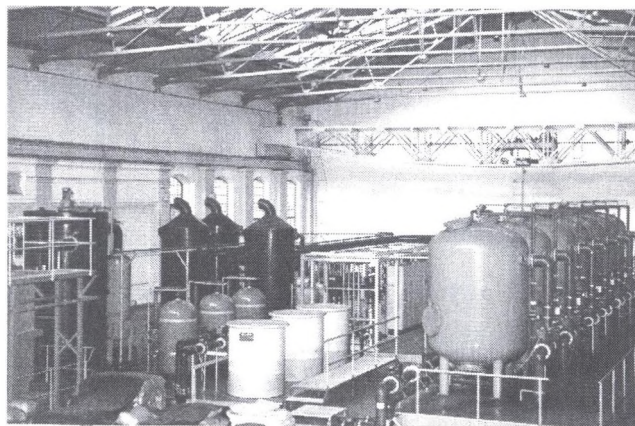
Fot. 5. Stacja Uzdatniania Wód Dołowych Photo 5. Mine water conditioning station
