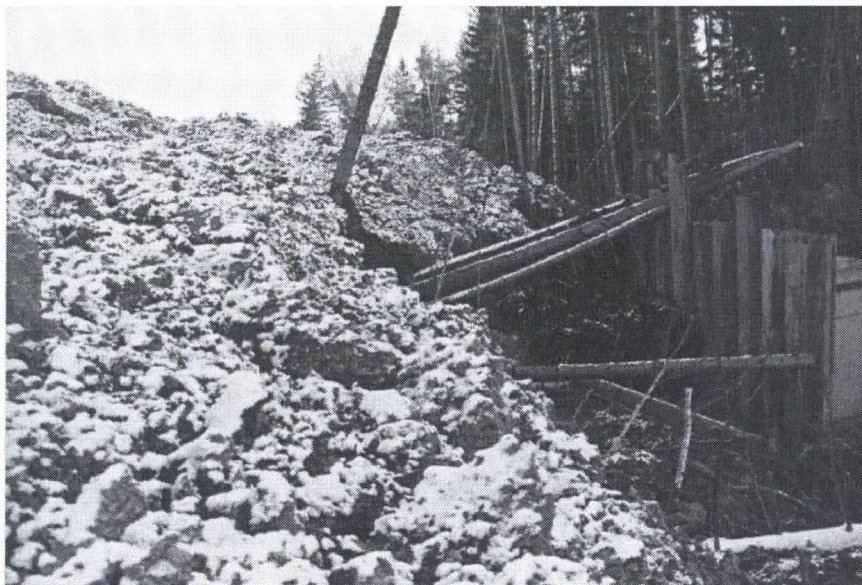
Fot. 2. Osuwisko „Świniec” na zwałowisku zewnętrznym KWB Turów Phot. 2. Landslide „Świniec” at outer dump Turów mine
