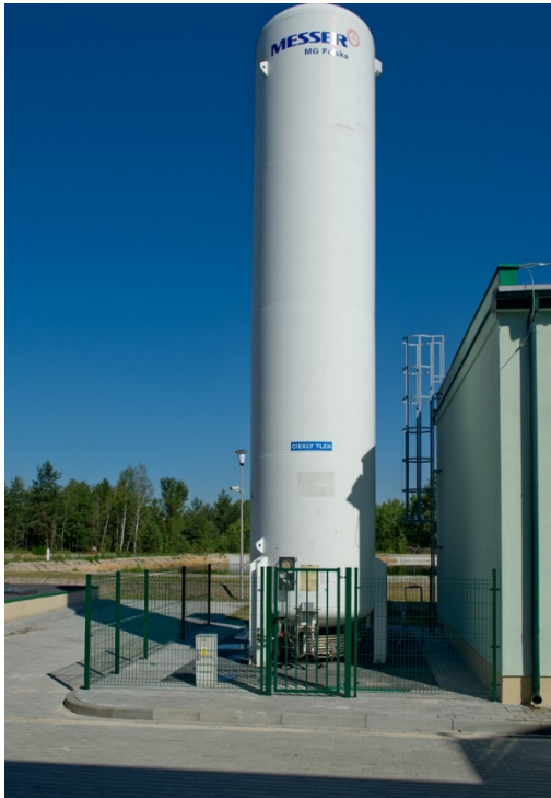
Rys.7. Zbiorniki tlenu na SUW Piaskownia
