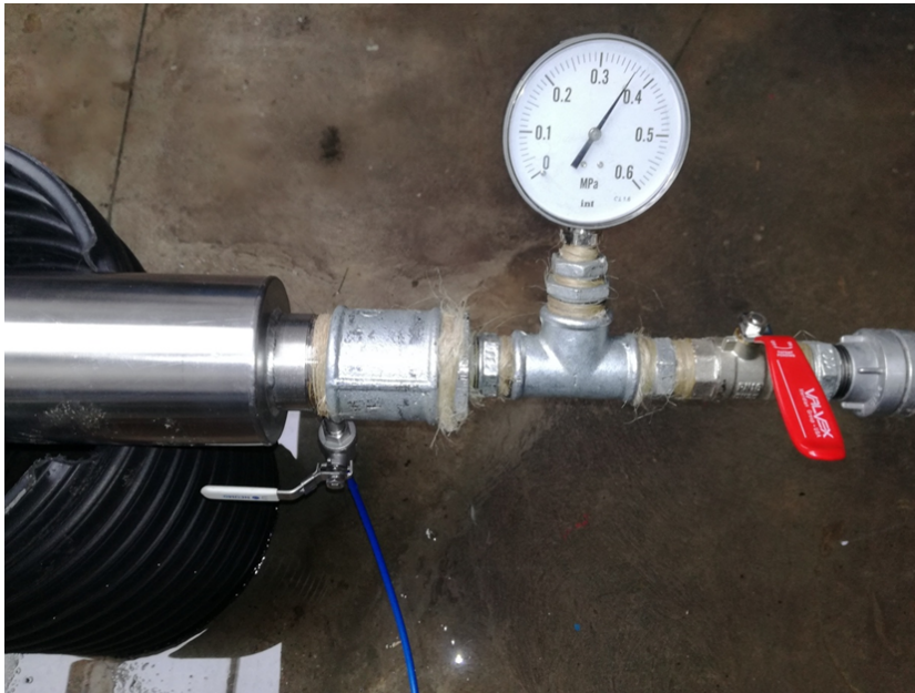
Rys. 25. Manometr z rurką Bourdona firmy INT Technics zainstalowany w układzie modelowym
