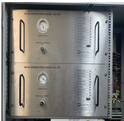
Rys. 16. Blok generatora ozonu typu WO-75F na SUW J. Dąbrowski
