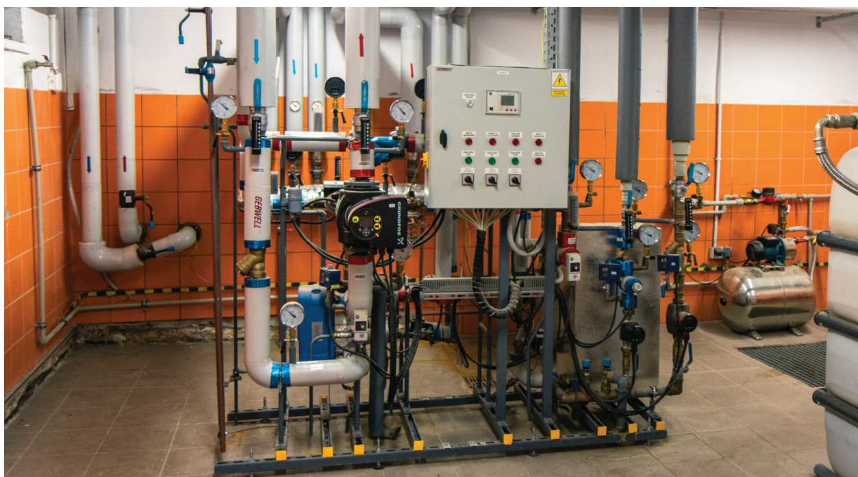
Fragment instalacji do odzysku szarej wody
