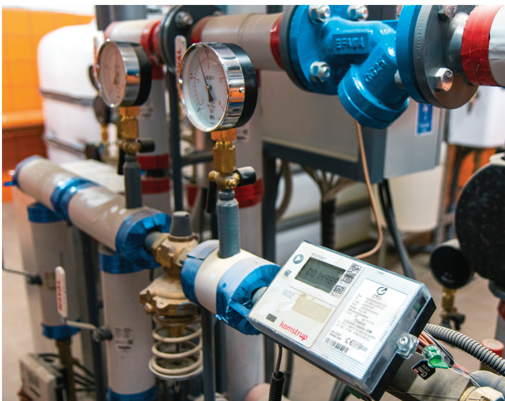
Fragment instalacji do odzysku szarej wody
