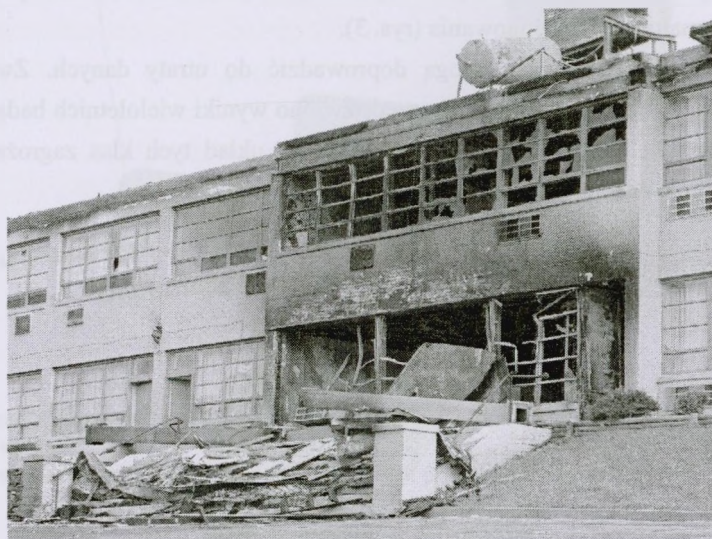
Rys. 2. Zniszczenia infrastruktury w wyniku katastrofy [23]
