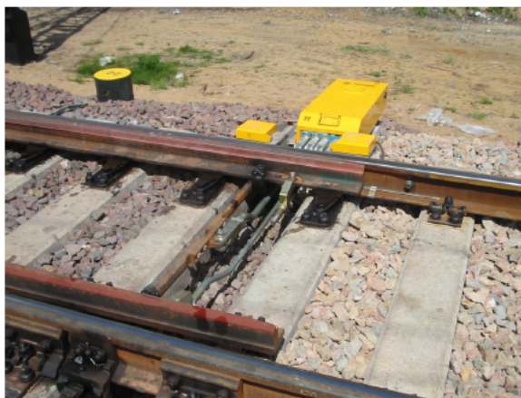
Rys.1. Napęd zwrotnicowy zabudowany przy rozjeździe [7]
