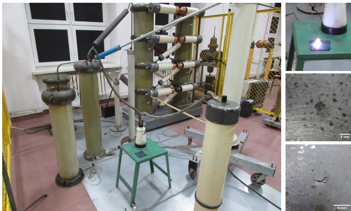
Rys.3. Układ pomiarowy podczas badań wysokonapięciowych, moment wyładowania elektrycznego oraz uszkodzenia spowodowane tymi wyładowaniami [23]
