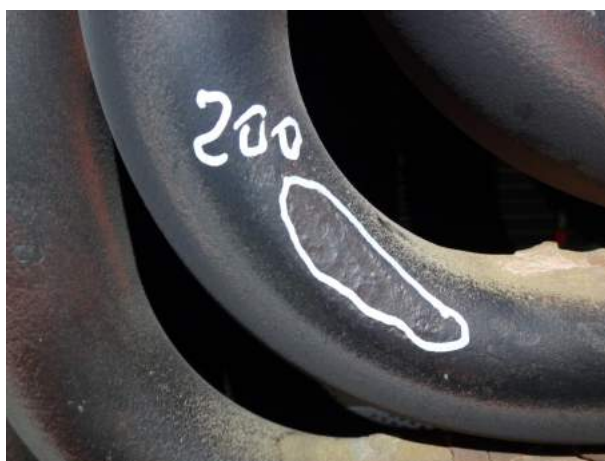
Rys. 1.9. Erozja ścianki rury kolana przegrzewacza grodziowego
