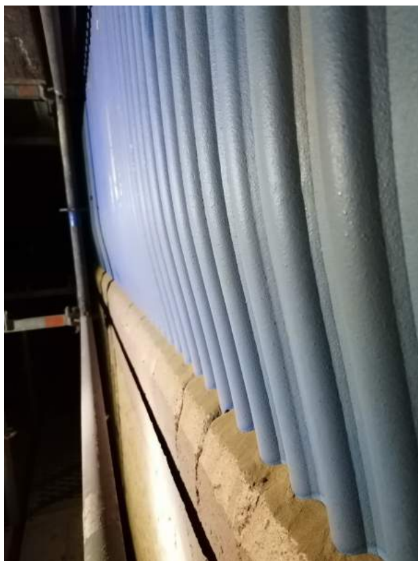
Rys. 1.11. Odgięcie rur parownika tuż powyżej linii zakończenia obmurza
