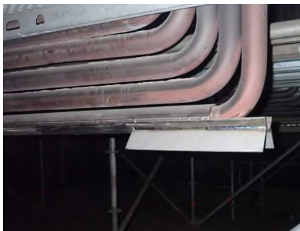
Rys. 1.8. Osłona skrajnej rury przegrzewacza grodziowego
