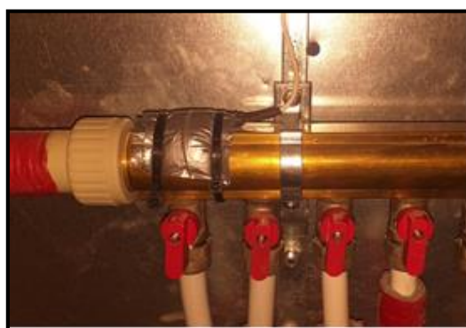
Rys. 7. Miejsce instalacji czujnika temperatury na wejściu rozdzielacza.
