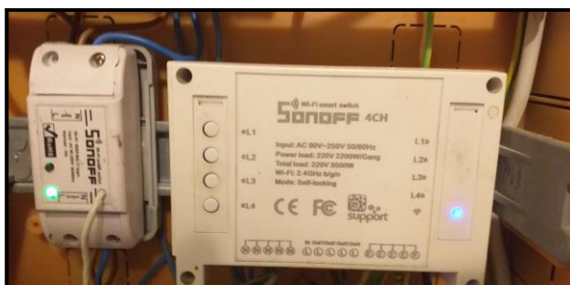
Rys. 5. Zainstalowane sterowniki Sonoff Basic i Sonoff 4CH w rozdzielnicy kotłowni.
