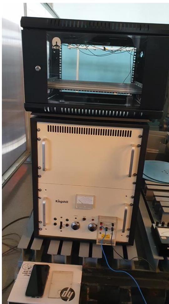
Rys. 10. Zasilacz z modułami PV (pierwotna wersja zabudowy w szafie sterowniczej)
