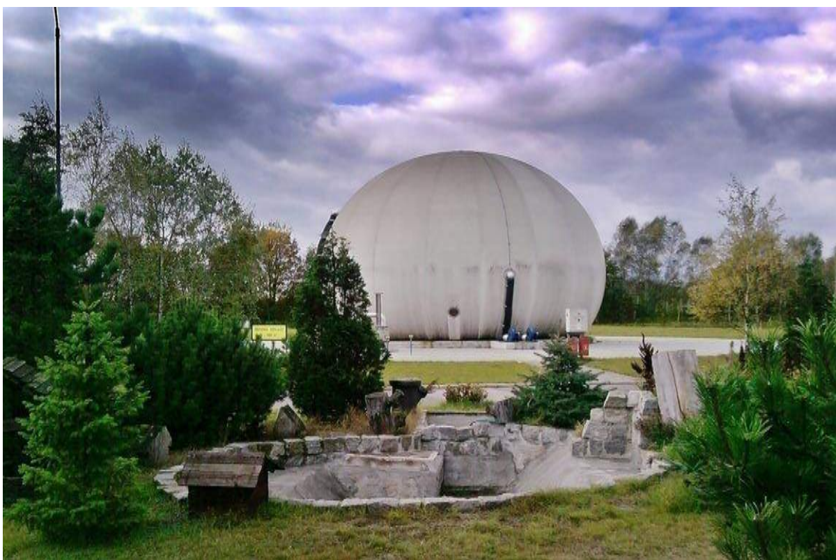
Zdjęcie 3 Zbiornik biogazu w Oczyszczalni Śródmieście
