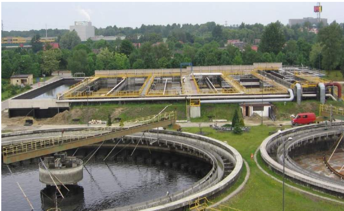
Zdjęcie 1. Osadnik wtórny i wielofunkcyjny reaktor biologiczny (JHB) w Oczyszczalni Śródmieście
