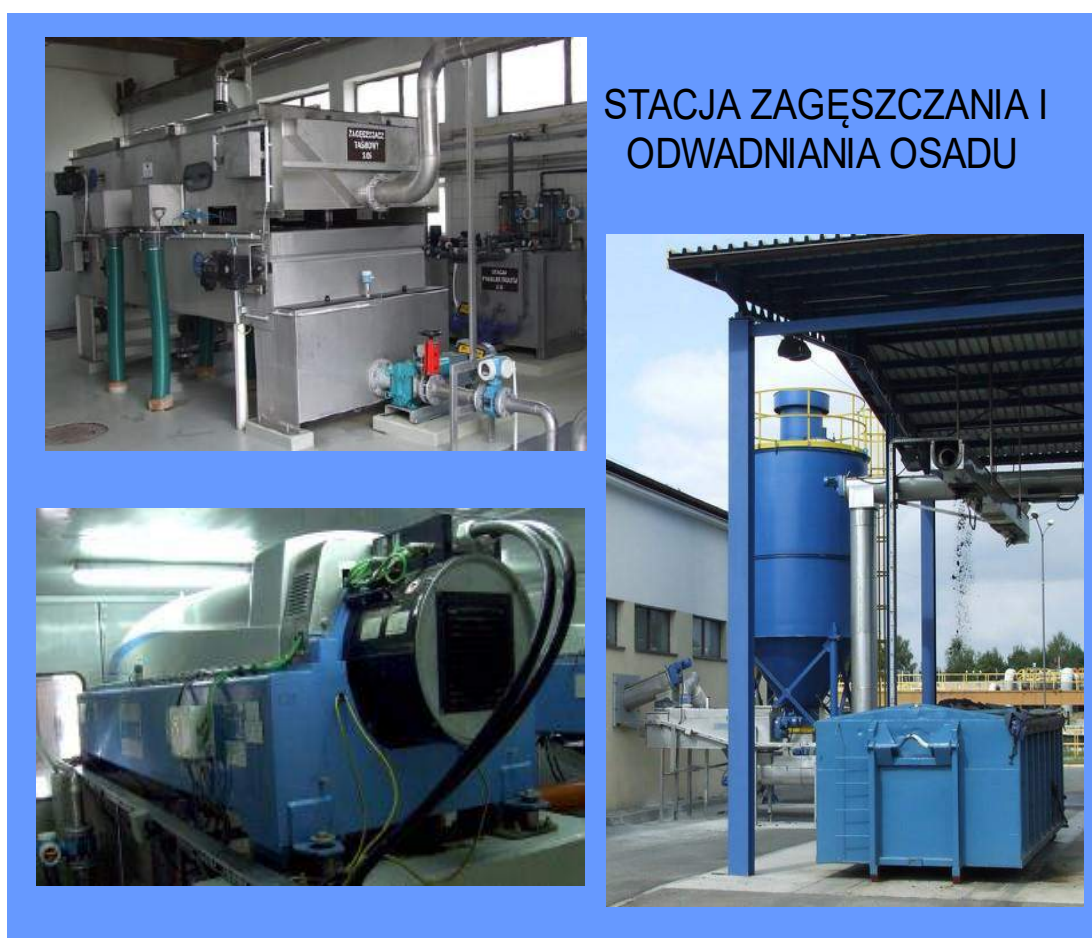
Zdjęcie 2 Urządzenia węzła przeróbki osadu w Oczyszczalni Śródmieście
