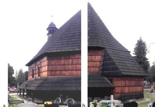
Widok fragmentu elewacji: a. fragment elewacji południowo-wschodniej, b. fragmentu elewacji wschodniej z przylegającą od północnego wschodu zakrystią. Fotografie własne, 2018 r.
