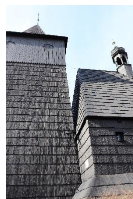
Widok odchylenia konstrukcji wieży od ściany szczytowej nawy. Fotografia własna, 2020 r.
