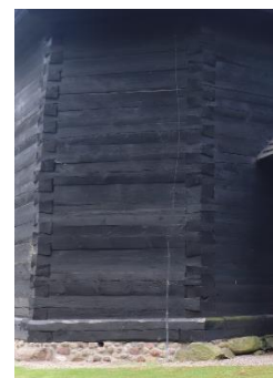
Widok fragmentu ściany zamykającej prezbiterium, połączenie belek w węglach na jaskółczy ogon. Fotografia własna, 2021 r.
