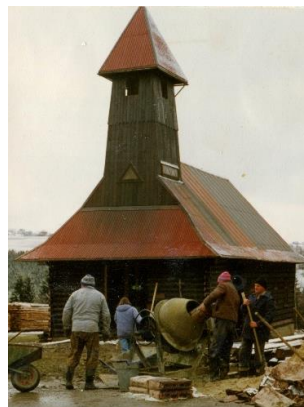
Fotografia z budowy kościoła. Źródło: zdjęcia z kroniki parafialnej prowadzonej przez Teresę Kukuczkę, mieszkankę Istebnej
