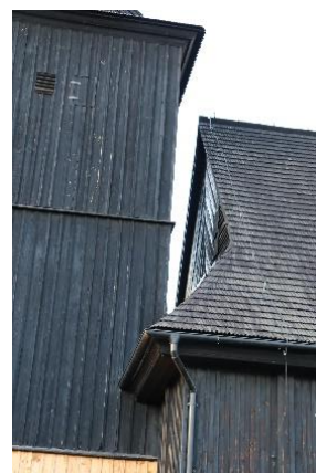
Odchylenie wieży od ściany szczytowej nawy. Fotografia własna, 2019 r.
