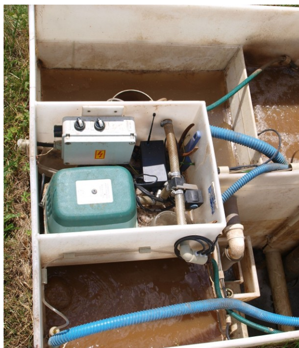
Rys. 2. Układ nadajnika w komorze sterującej Fig. 2. Transmitting unit in control chamber
