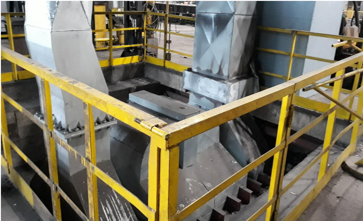
Rysunek 1.6. Rekuperator spaliny-powietrze zainstalowany w kanale spalinowym na walcowni rur. Energia odpadowa spalin jest wykorzystywana do podgrzania powietrza kierowanego do procesu spalania
