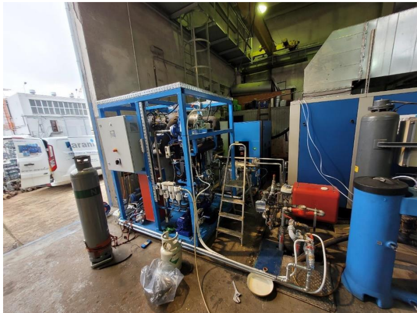
Rysunek 5.8. Układ ORC w trakcie testów przemysłowych na terenie stoczni CRIST. Ciepło przekazywane jest od dwóch sprężarek Marani DS200/H o mocy elektrycznej 200 kW za pośrednictwem wody.
