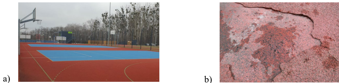
Rys. 4.35. a) Przykładowe boisko z syntetyczną nawierzchnią EPDM, b) uszkodzona, użytkowa syntetyczna nawierzchnia sportowa na bazie EPDM (podbudowa i warstwa wierzchnia) Fig. 4.35. a) An example of a sports field with a synthetic EPDM surface, b) a damaged post-consumer synthetic sports surface based on EPDM (base and top layer)
