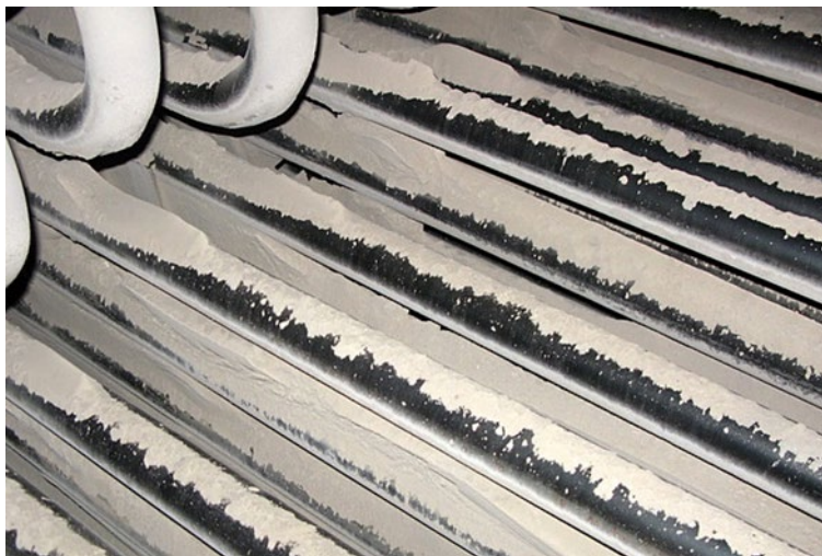
Rys. 2.12. Przykład osadu sypkiego na rurach przegrzewacza pary wtórnej Fig. 2.12. Example of powdery deposit on reheater tubes
