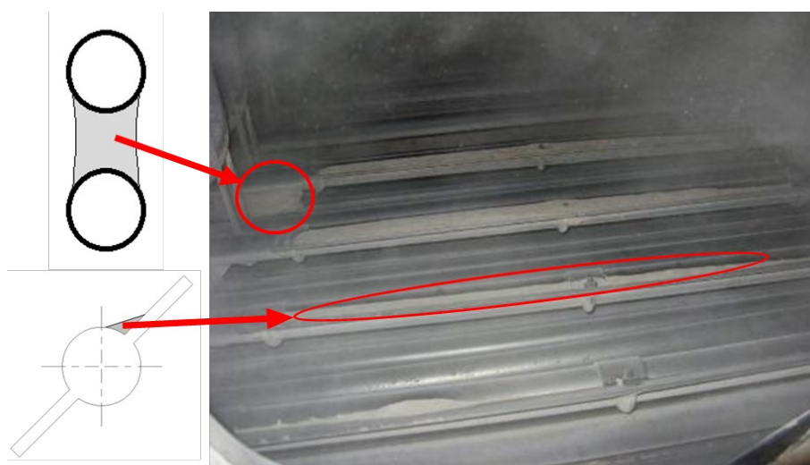
Rys. 2.20. Klin osadu na powierzchni napływowej żeber oraz lokalny mostek popiołowy Fig. 2.20. A wedge of sediment on the alluvial surface of the fins and a local ash bridge
