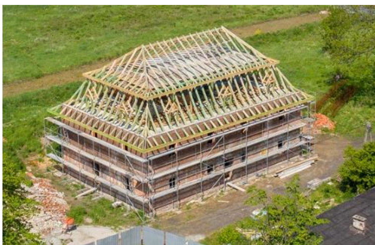
Rys.V.47. Deweloperska „rekonstrukcja” dworu w Strumieniu
