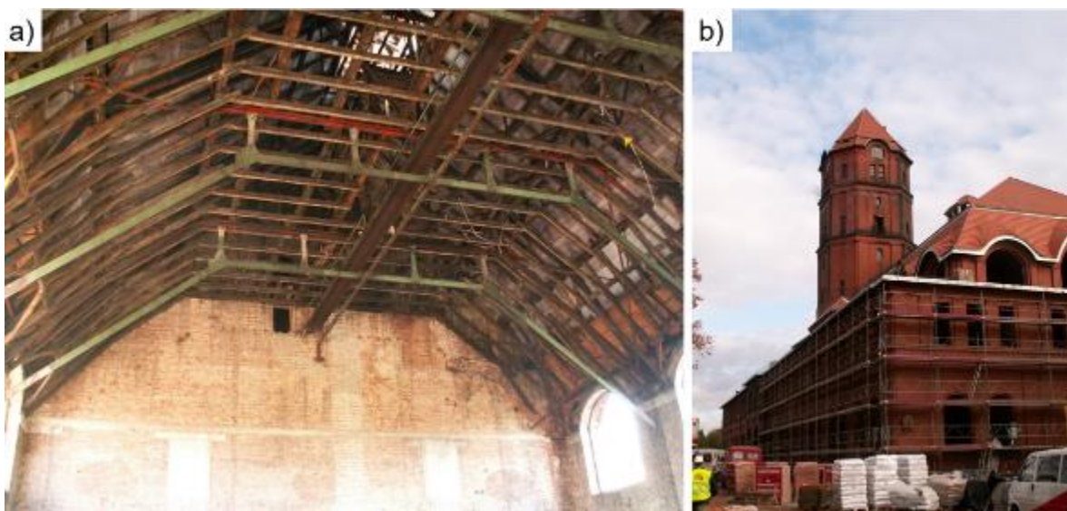
Fig. 19.7. Machinery hall during reconstruction: a) historic roof truss, b) façade Rys. 19.7. Cechownie podczas przebudowy: a) historyczna więźba dachowa, b) fasada
