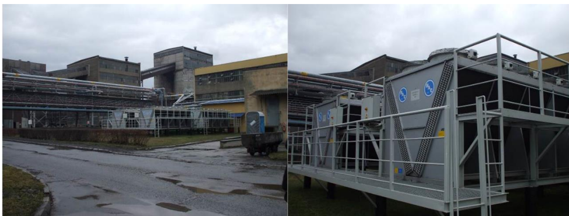
Rys. 15.8. Instalacja free-cooling w KWK „Pniówek” [zdjęcia autorskie] Fig. 15.8. Free-cooling installation at KWK "Pniówek" [author's photos]
