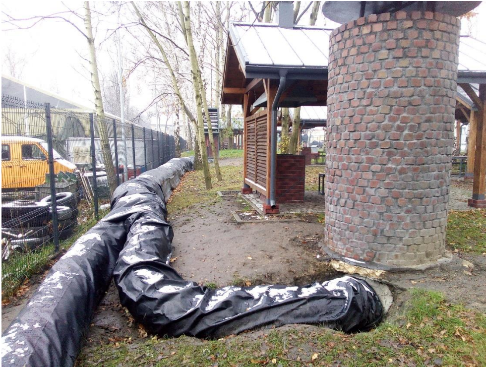
Rys. 14.3. Lutniociąg zainstalowany na powierzchni łączący otwór W(2015) z otworem W(2016) – rekuperacja [zdjęcie autorskie]
