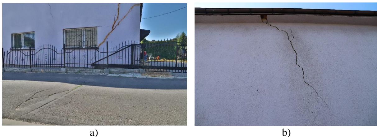
Rys. 8.7. Uszkodzenia wschodniej ściany budynku: a) stopień terenowy na drodze i symetryczne pęknięcia elewacji, b) pęknięcia poddasza
