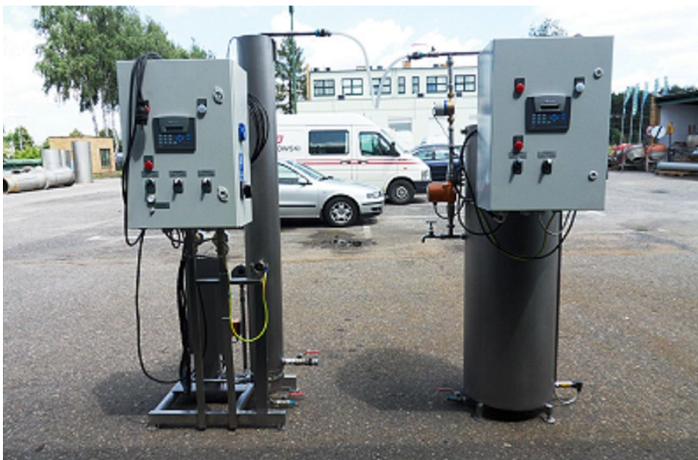
Rys. 5.3. Zdjęcie przedstawiające modelową stację uzdatniania wody zainstalowaną w Broniszach z widocznymi szafami sterowniczymi
