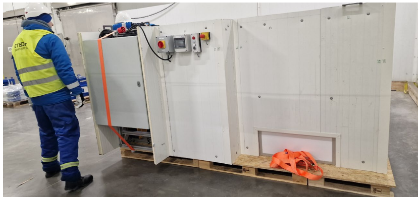
Rys. 3. Automatyka stacja wymiany akumulatora SAWA: a) przed zaizolowaniem b) po zaizolowaniu
