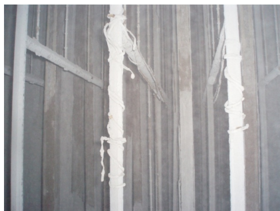
Rys. 14. Elektroda ulotowa w postaci taśmy kolczastej zamocowanej w ramie – efekt uszkodzenia (zerwania taśmy) [10]
