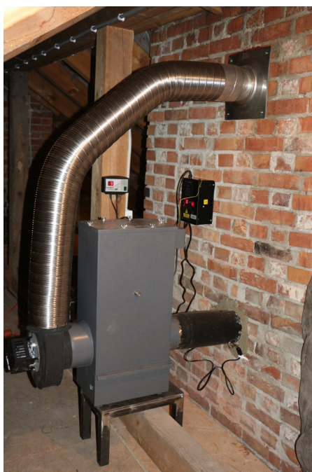
Rys. 22. Innowacyjny elektrofiltr kominowy zamontowany w budynku mieszkalnym w Goczałkowicach-Zdroju [54, 57]
