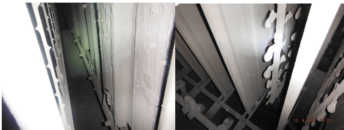
a) b) Rys. 16. Nadmierne osady pyłu na elektrodach: a) zbiorczych, b) ulotowych, świadczące o nieprawidłowej pracy odpylacza (zdjęcie własne autora)
