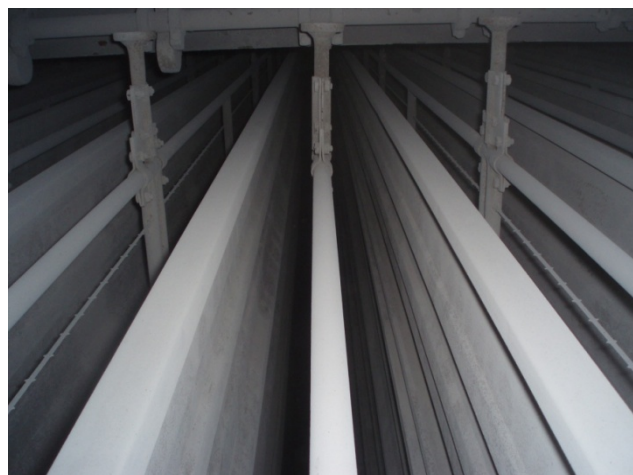
Rys. 10. Płaski układ elektrod (elektroda zbiorcza typu Sigma i elektroda ulotowa ramowa taśmowa) [10]
