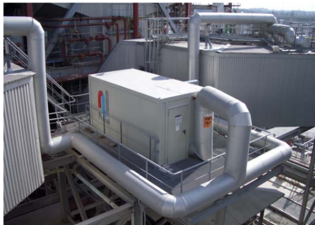
Rys. 17. Kontener z instalacją kondycjonowania spalin [39]
