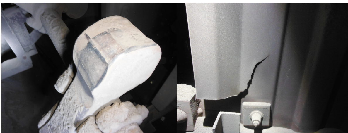
Rys. 31. Przykłady eksploatacyjnych uszkodzeń elementów sekcji elektrod zbiorczych: a) deformacja młotków strzepywaczy, b) propagacja pęknięć w strefie mocowania elektrody zbiorczej do drąga strzepującego (zdjęcie własne autora)
